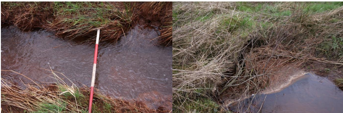
Figur 14 Nørrekjær til Banen. På billede tv ses en indsnævring af profilet opstrøms banen til en ovenbredde på ca. 50 cm. På billede th ses en ansamling af grene i indløbet til rørbro omkring St. 2.000 m umiddelbart opstrøms banen.
