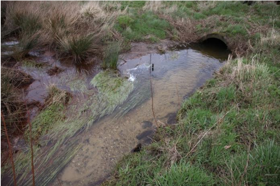
Figur 13 Nørrekjær til Banen. På billedet ses udløbet af en rørbro omkring st. 1.200 m, hvor er der et spulehul i udløbet og en opbygning af sand ca. 3 m nedstrøms. Endvidere er der et drænudløb 3 m nedstrøms rørbroen på modsatte side. Drænet er neddykket under vandløbets bund.
